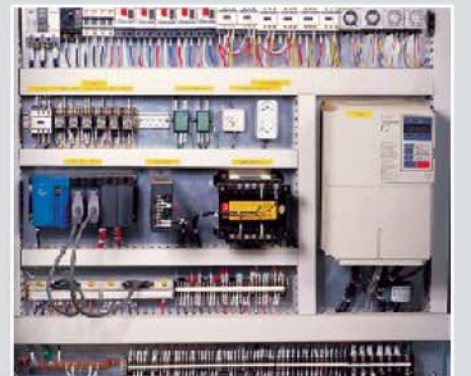
Elektrik Panosu ve PLC
